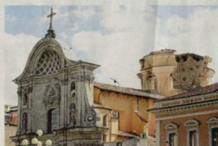
Eingestürzte Kuppel: Die Kathedrale in L'Aquila wurde durch das Erdbeben schwer beschädigt.
